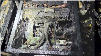
배터리팩 전원 접속부(전기적 특이점 관찰 안됨)
